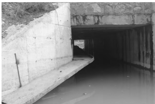
图 8 涵洞通道侧壁设置平台小道,便于雨季时中小型哺乳动物利用涵洞通道穿越
